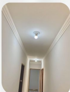
Molduras em Gesso
